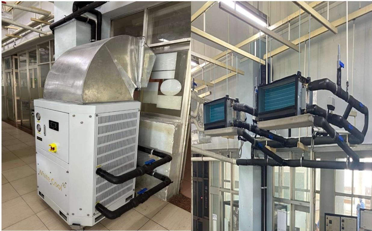
Hình 5: Mô hình hệ thống DHKK Water Chiller bố trí trong phòng F4.10B
