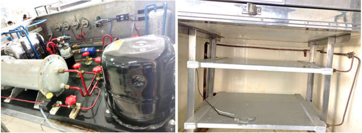
Hình 3. Cụm thiết bị nhiệt tủ cấp đông tiếp xúc.
