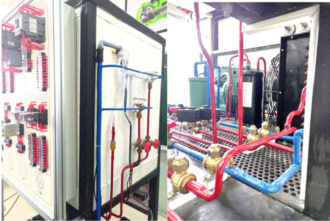
Hình 2. Cụm thiết bị nhiệt vận hành.
