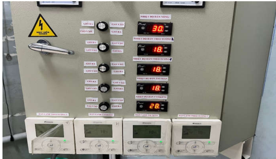
Hình 2. Tủ điện điều khiển mô hình điều hòa không khí trung tâm VRV IIIQ
