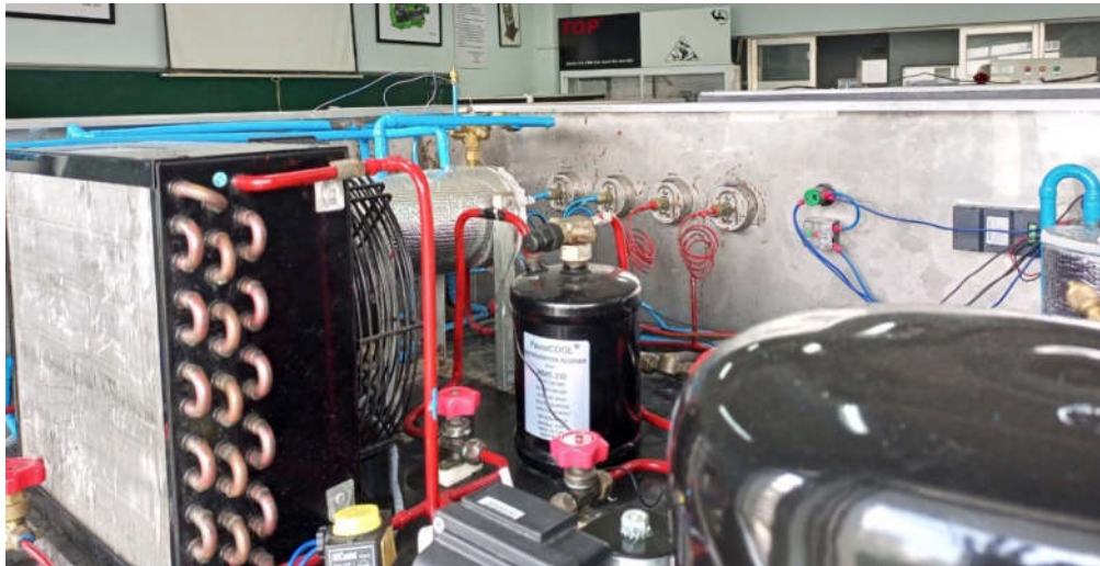
Hình 2. Cụm thiết bị nhiệt vận hành.
