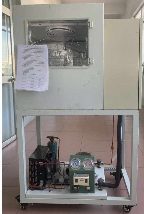
Hình 1. Hình ảnh thực tế mô hình kho lạnh công nghiệp
