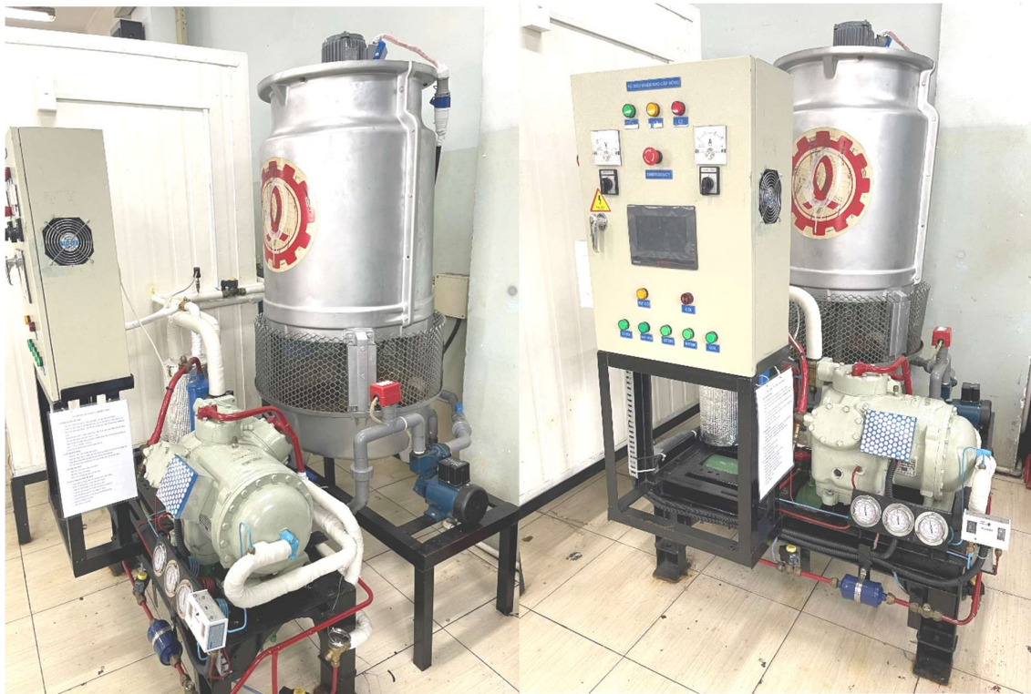
Hình 1. Mô hình hệ thống Kho cấp đông 2 cấp sử dụng thiết bị làm mát trung gian ống lồng ống điều khiển và giám sát thông qua PLC bố trí trong phòng F4.1
