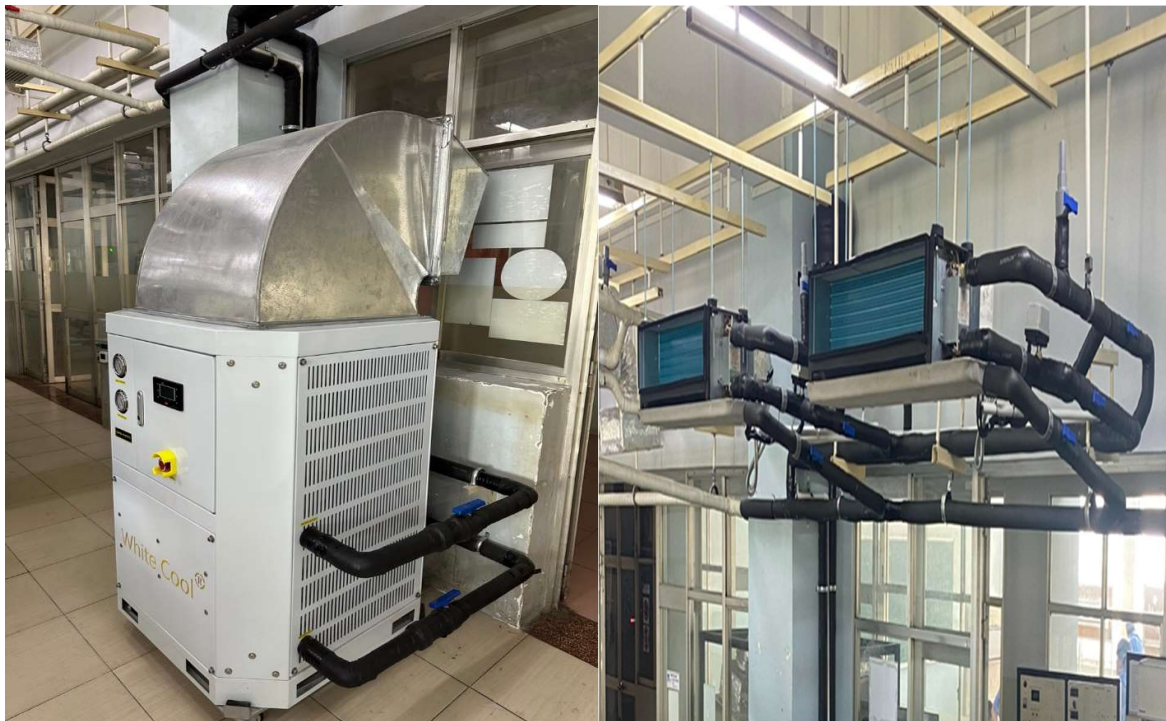
Hình 1. Mô hình hệ thống ĐHKK Water Chiller bố trí trong phòng F4.10B
